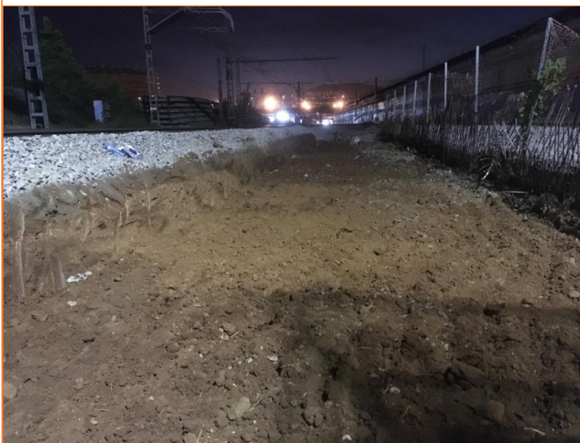
Foto 14. Vista de la part nord un cop assolida la cota final d'obra. Fase 2.
