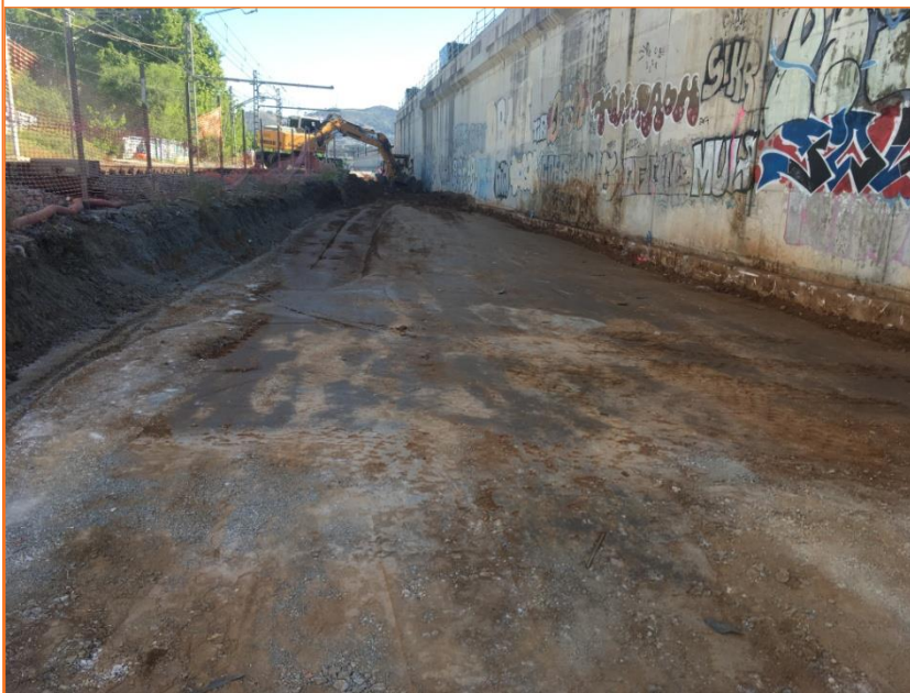
Foto 16. Vista de l'estat final amb el tall per edificar la pantalla a l'est. Fase 2.
