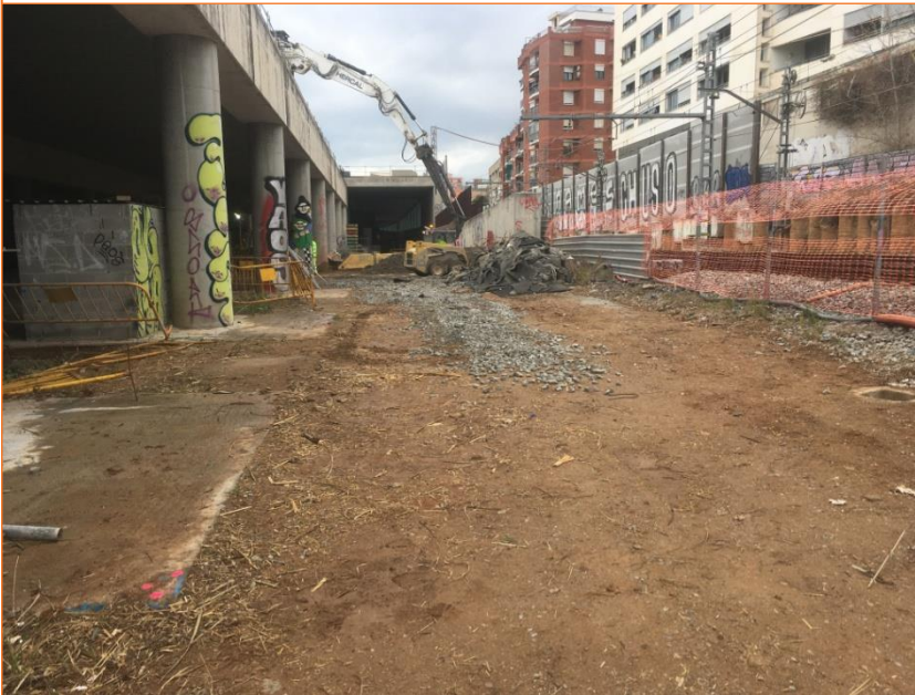
Foto 5. Vista inicial abans de començar els rebaixos al subsòl a la capçalera nord. Fase 1.
