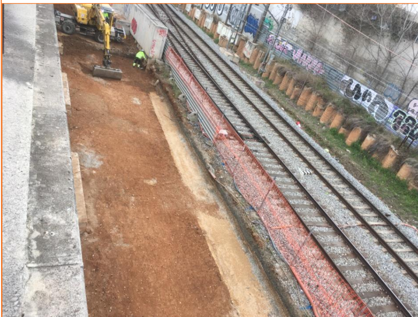
Foto 10. Vista final de la zona dels rebaixos a la capçalera nord. Fase 1.
